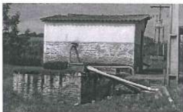
Foto 3.9 – Reservatório de água tratada
