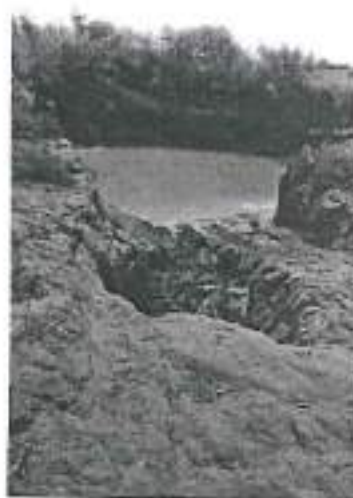
Foto 3.27 – Outra vista da erosão
