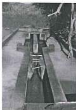
Foto 3.21 – Tratamento preliminar e Calha Parshall
